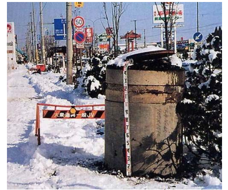
浮いてきたマンホール
